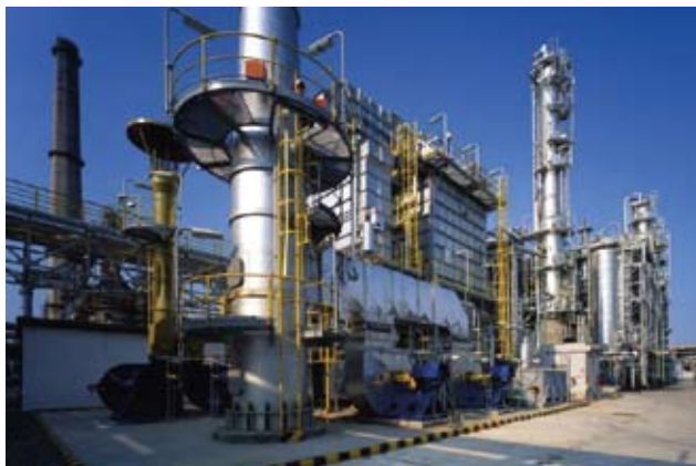
▲ Pohled na jednotku visbreakingu, kterou najdete ve výrobní části Chemparku Záluží.
