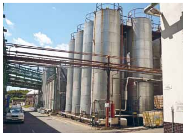
▲ Po rekonstrukci nadzemních nádrží bude skladování surovin a finálních produktů v Kolíně odpovídat nejlepším dostupným technikám. Foto Pavel Barcal.
