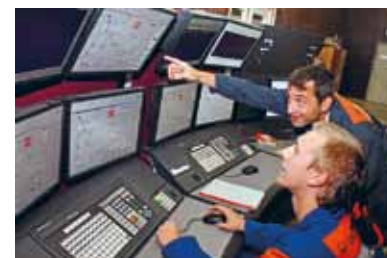
▲ Člen kontrolního týmu, Zdeněk Pudil, se zajímá, jak se operátorovi velínu T700 pracuje u nových stanic.
