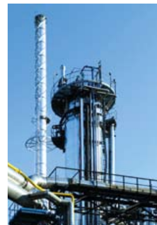
▲ Výroba veškerých základních druhů asfaltů by nebyla možná bez bezporuchového chodu technologií, tedy i základní jednotky Biturox.
