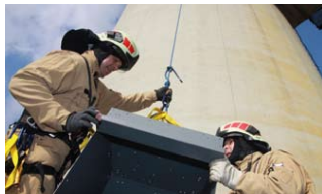
▲ O dva týdny později (1. března) již hasiči Unipetrolu RPA instalují první budku pro sokola stěhovavého na komínu teplárny T700.
