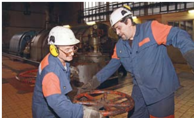
▲ Po vypnutí odstavené turbíny je potřeba uzavřít vstupní armatury.
