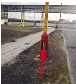
Nebezpečí zasažení elektrickým proudem
